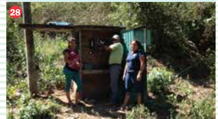
SOLUCIONA GOBIERNO EL PROBLEMA ELÉCTRICO EN LA BOMBA DE AGUA DE "EL MAGISTRAL".
